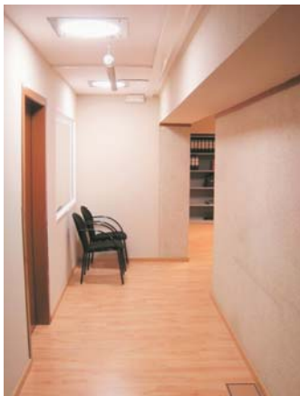
Vista de un pasillo sin ventanas iluminado por 2 tubos de luz DEPOSUN 400
