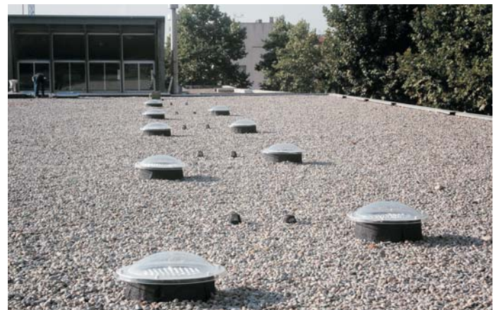
Los conductos de sol transportan la luz desde la cubierta plana hasta el pasillo central.
